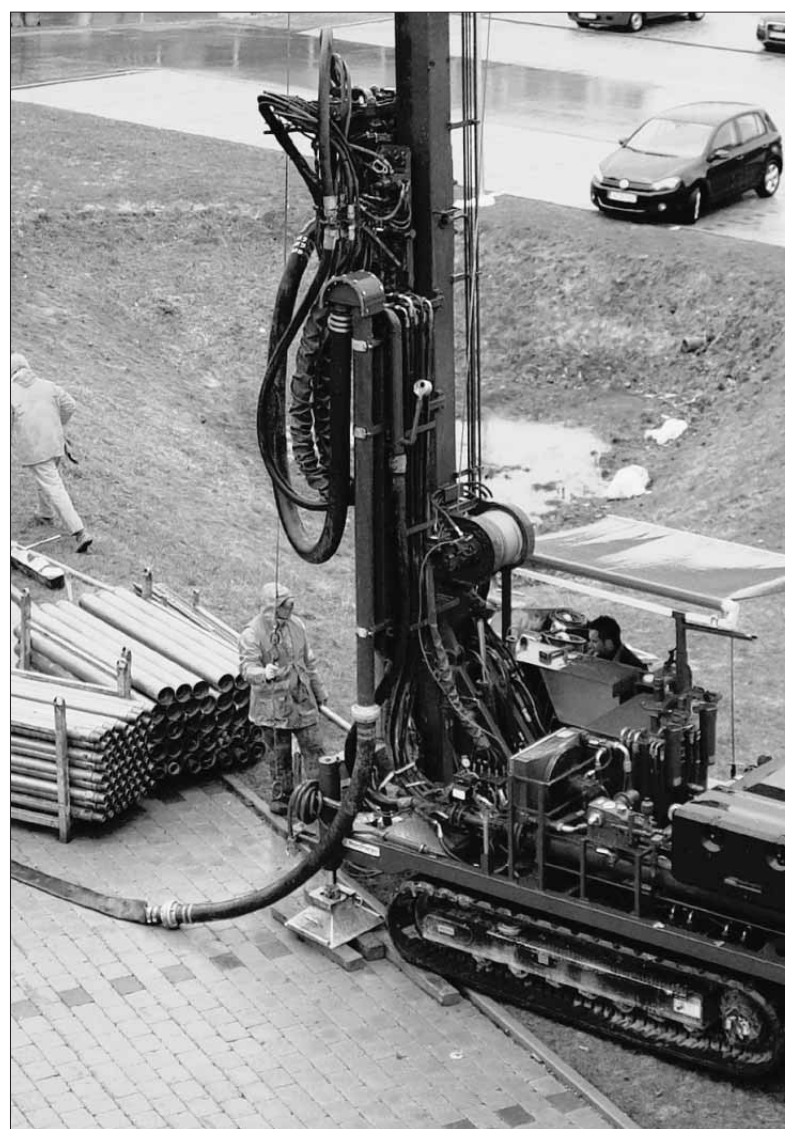
Erdbohrungen kündigen es an: wenglor setzt auf Erdwärme und will zusammen mit Maßnahmen der Wärmedämmung den CO2-Ausstoß um jährlich 300 Tonnen reduzieren. Foto: pr
